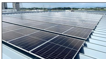
合志支店 太陽光パネル
