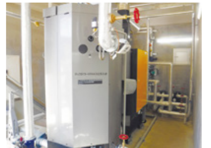
温泉館「きよら」の木質バイオマスボイラー
