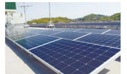
市庁舎に設置した太陽光発電
