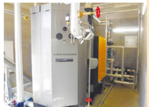
きよら温泉館の木質バイオマスボイラー
