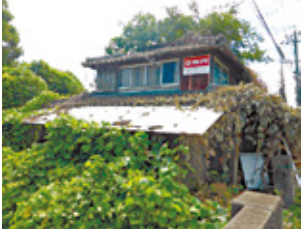
放置された空き家
